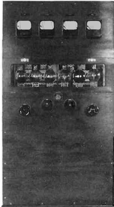
100 KW Rectifier Control Panel
